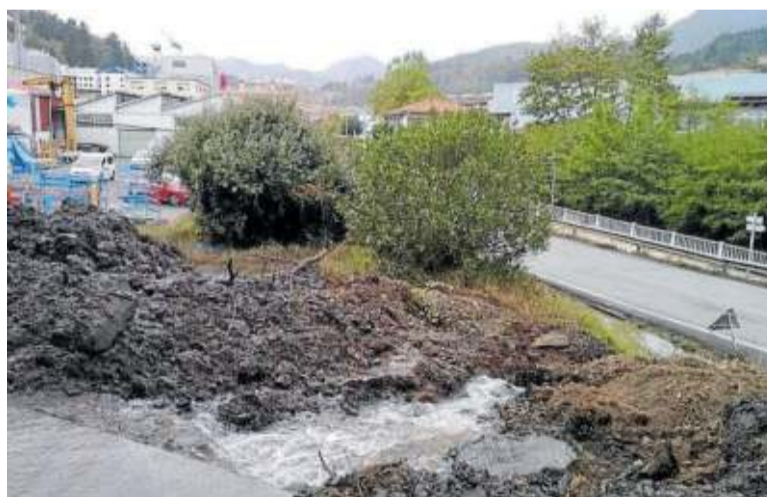
El punto de la avería, entre el hospital y el puente de Osiña. Foto: A.D.
