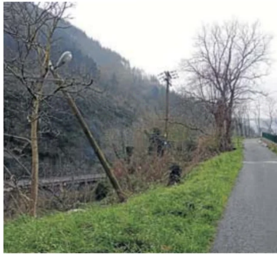
Postes de luz y telefonía de Aizpizkar kalea, en mal estado. UDALA
